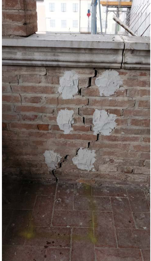
Lesioni connesse al ribaltamento della facciata
