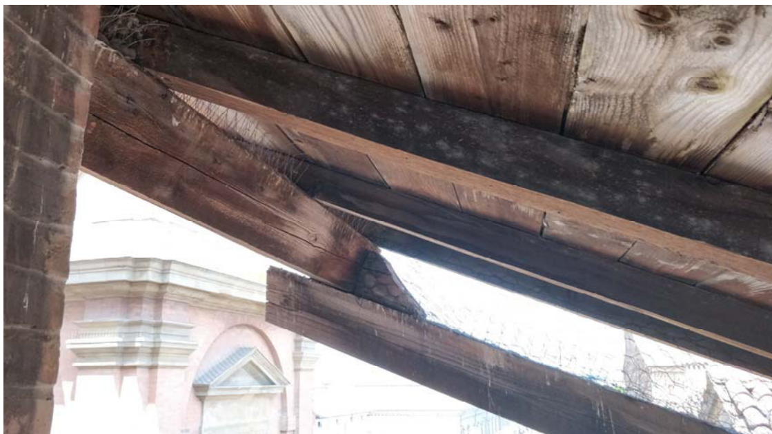
Copertura della loggia sul lato che affaccia e sbalza verso la torre dell'orologio
