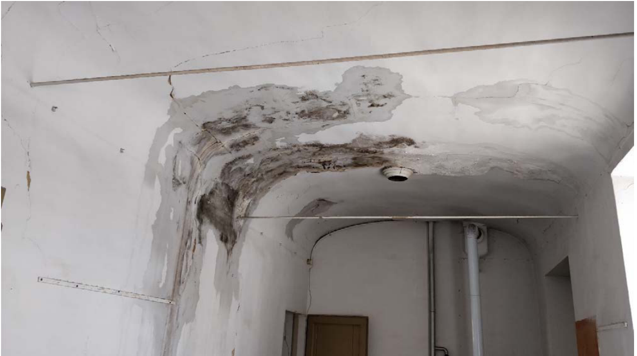
Vista dei locali interni con evidenti segni di degrado dovuto ad infiltrazioni di acque meteoriche dalla copertura
